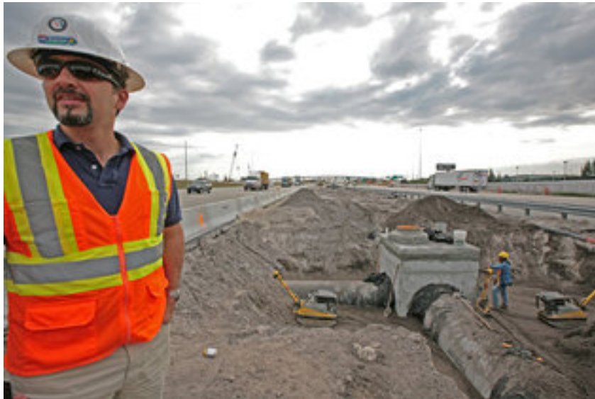
Sergio González, ingeniero de proyectos de PE Metric Engineering, supervisa las obras de reconstrucción de la I-595 en Broward el lunes. ALEXIA FODERE-EL NUEVO HERALD
